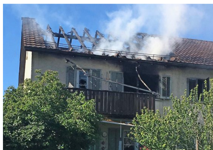
Blick auf den zerstörten Dachstock. Foto: Till Hirsekorn
